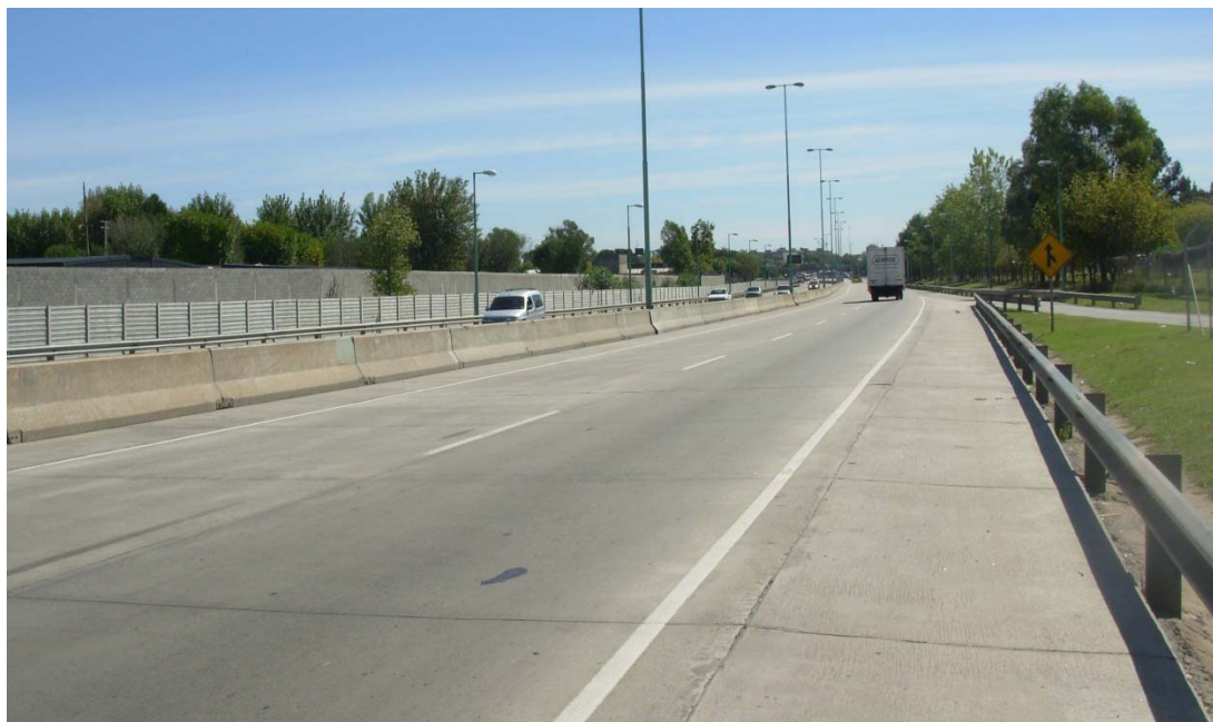
Figura N° 4. Calzada de hormigón con sobreancho en carril externo y banquetas de hormigón vinculadas
