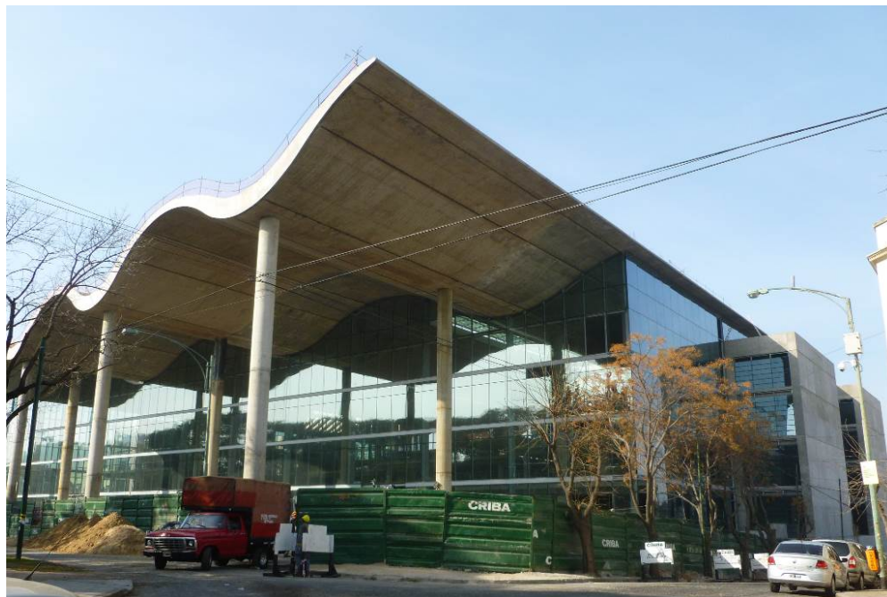
Vista del frente de la obra. Se aprecia claramente la variación del espesor de la cubierta y su forma abovedada.
