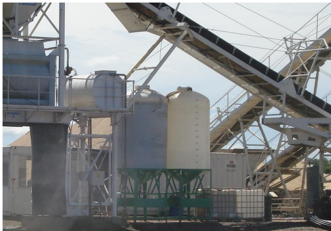
Figura 1. Depósitos de aditivos en planta hormigonera.
