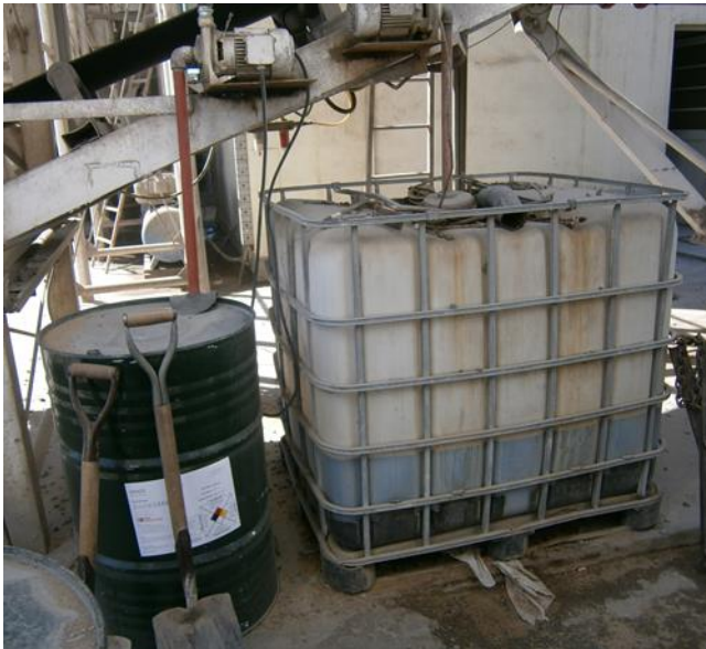
Figura 5. Sistema de acopio de aditivos en planta.
