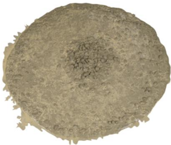
Figura 3d. IEV=3 Concentración de agregado grueso en el centro de la masa de hormigón y presencia de aureola de mortero.
