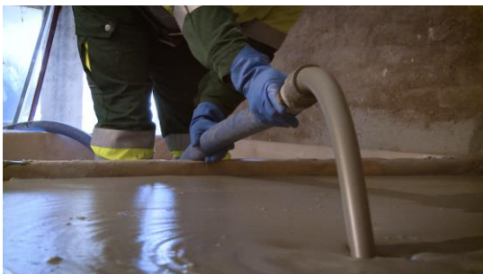
Figura 6. Uso de un MDRC como aislante térmico para la cubierta de una vivienda
