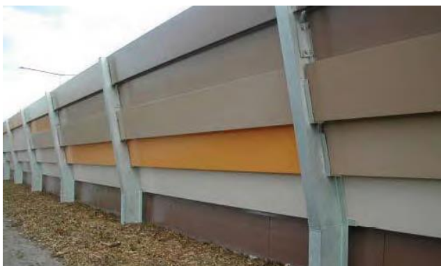
Ilustración 26: Inclínación de la barrera sónica, vista posterior al camino (15)
