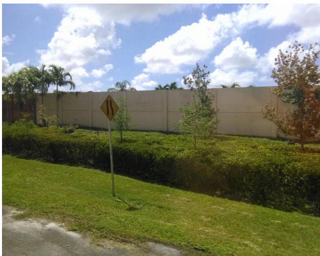
Ilustración 8: Barrera sónica de hormigón blanco
