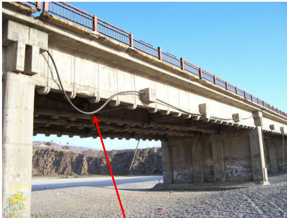
Corrosión en los cables del postensado
